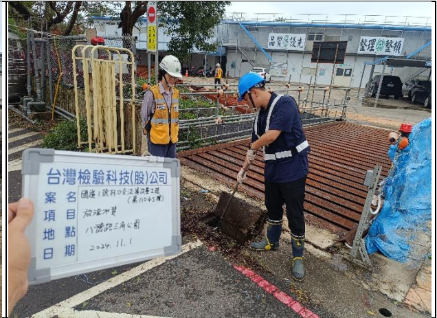
監測項目：放流水質 監測日期：2024.11.01 監測地點：八德路三角公園
